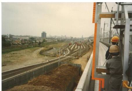
加茂宮～大成駅（現：鉄道博物館駅） 上り線建築限界検査 ※中央付近が現在の鉄道博物館
